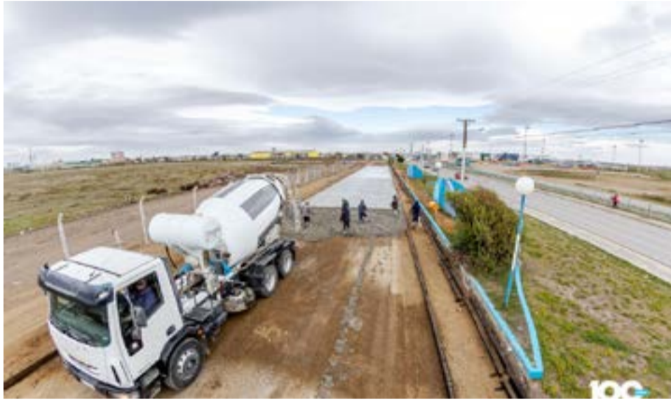
La arquitecta Silvina Mónaco, secretaria de Planificación, Inversión y Servicios Públicos del Municipio de Río Grande, dialogó con Radio Universidad 93.5 sobre el inicio del vertido de hormigón en la obra de la doble Santa Fe, que comenzó el viernes.
